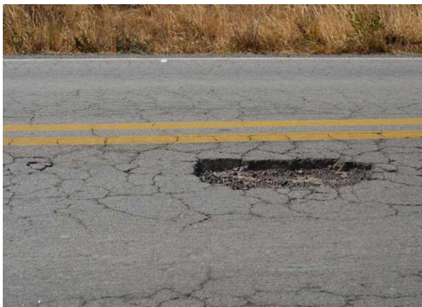
Buraco em trecho da rodovia severamente impactada. Este passivo será mitigado com a duplicação da rodovia (novembro/2012).
